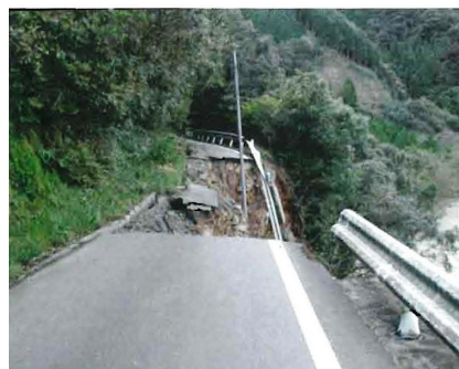
平成16年10月 道路寸断 (主要地方道 土佐清水市)
