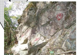
崩れる恐れのある斜面
