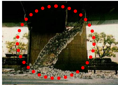
【阪神・淡路大震災により橋脚部が破壊】
